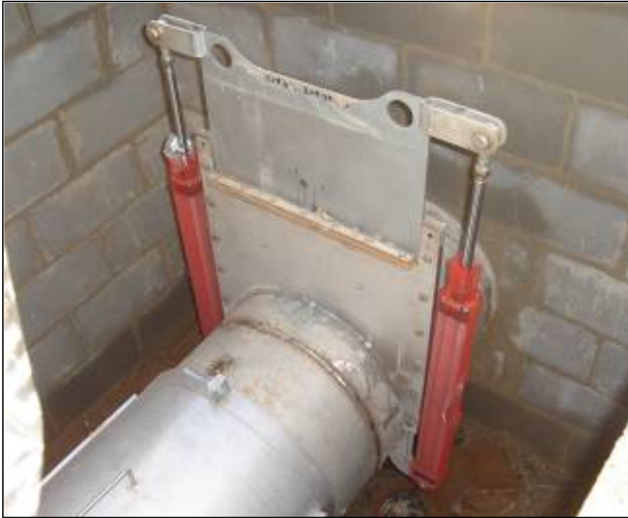
Figura 6. Sectorización en interior de arqueta de registro
