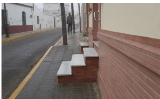
Escaleras invadiendo itinerario peatonal en C/Zurraque.
